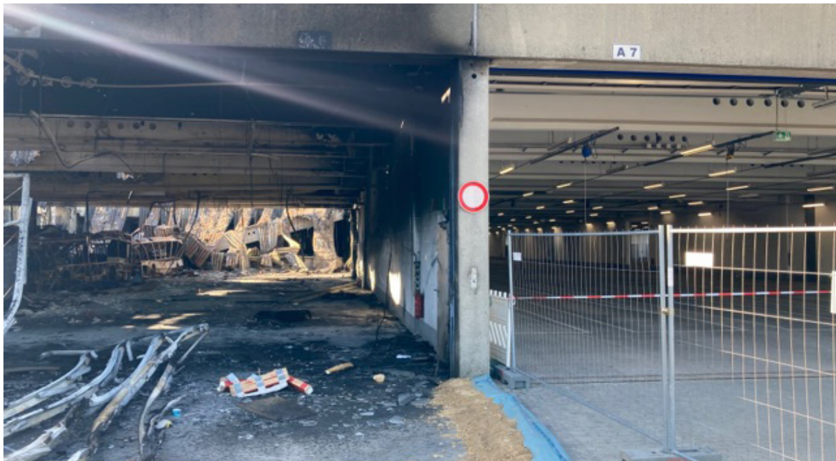
Bild 7-1: Brand in einer durch Brandwände unterteilten Abstellhalle: links vom Brand betroffener Brandabschnitt, rechts benachbarter Brandabschnitt ohne Brandeinwirkung. Busse aus diesem Bereich blieben unversehrt. (Bildquelle: ÜSTRA, Hannover)
