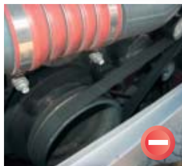
- Dieser Keilriemen zum Antrieb der Klimaanlage war ab Werk mit 9,5 cm zu schmal und neigte daher zum Wegfliegen. Seit der selbstständigen Umrüstung auf 13,5 cm hat sich das gebessert. Laut Graß hat MAN inzwischen nachgezogen.
